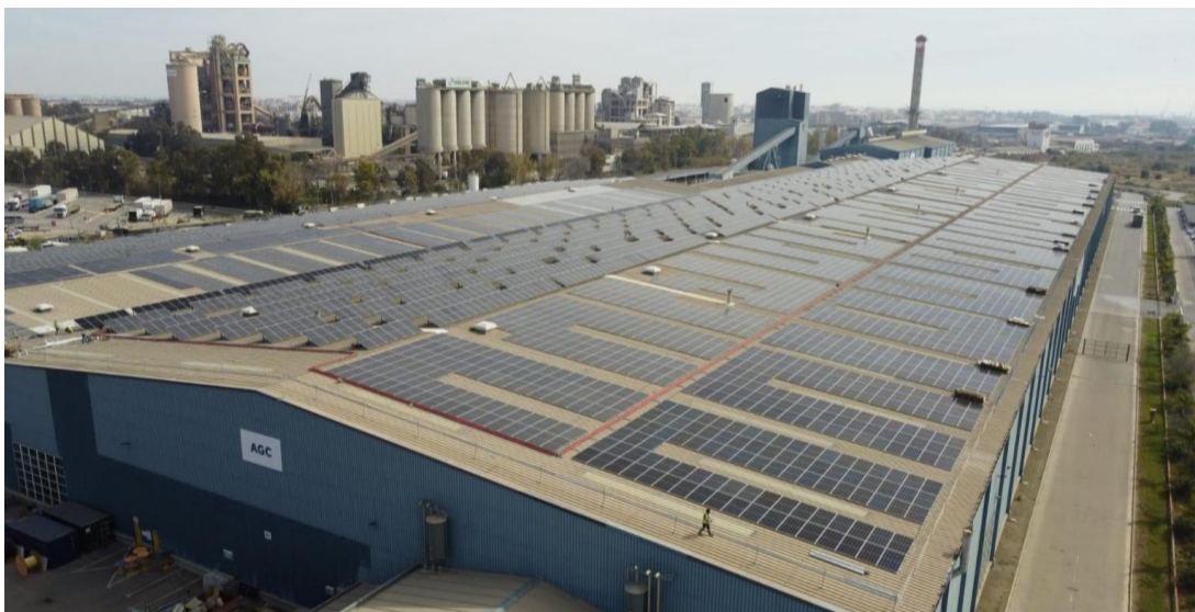
Figura 3. Industria electrificada con sistemas de autoconsumo fotovoltaico: integración de energías renovables en entornos productivos. Fuente: Helexia Group
